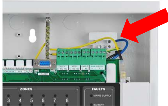
Fig. 18 – Ubicación del fusible de la fuente de alimentación
