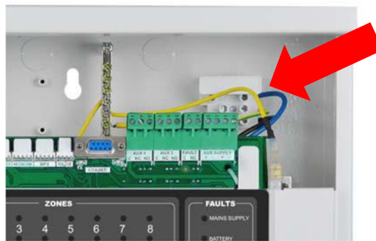
Fig. 38 – Fusible de alimentación de red de CA
