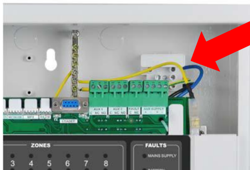
Fig. 18 – Ubicación del fusible de la fuente de alimentación
